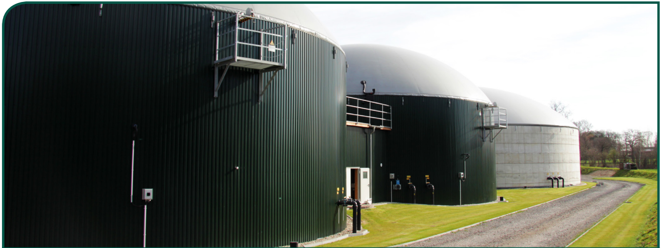
Leistung: 650 kW | Inbetriebnahme: 2011 | Fermenter Nachgärer
